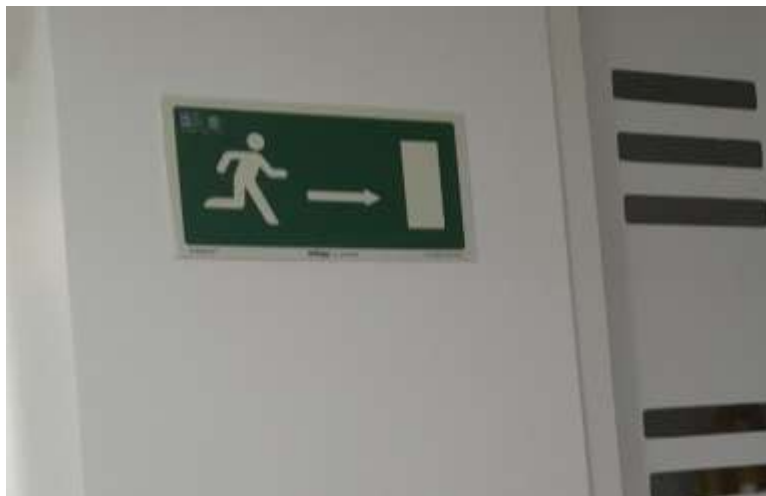
Figura 45 Ruta de evacuación y señalización de salidas de emergencias (ART. 7.10 – NFPA 101).
