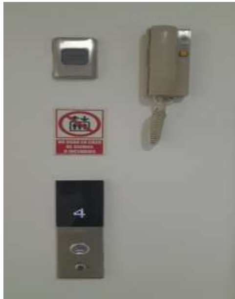
Figura 50 Elevadores no usar en caso de sismo o incendios.
