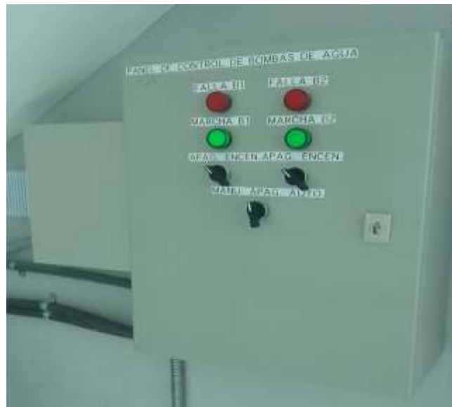
Figura 35 Panel de control de bomba de agua.
