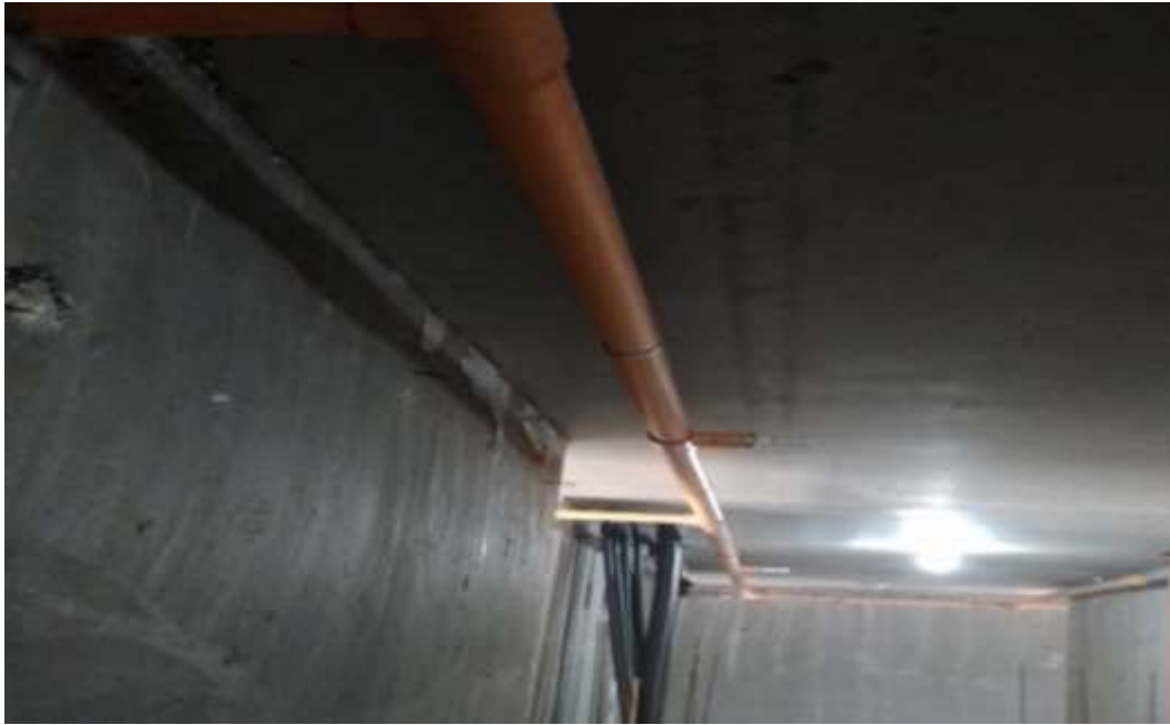
Figura 42 Sistemas contra incendios, norma (NFPA 13).
