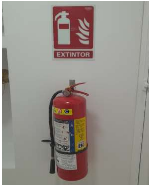
Figura 39 Extintor contra incendios, norma (NFPA-10).
