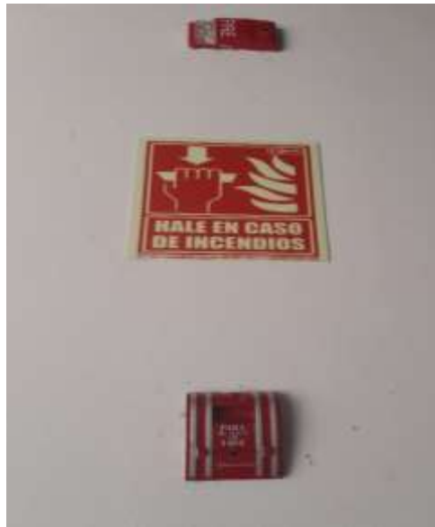
Figura 44 Alarma contra incendios, norma NFPA 72 / NFPA 101.
