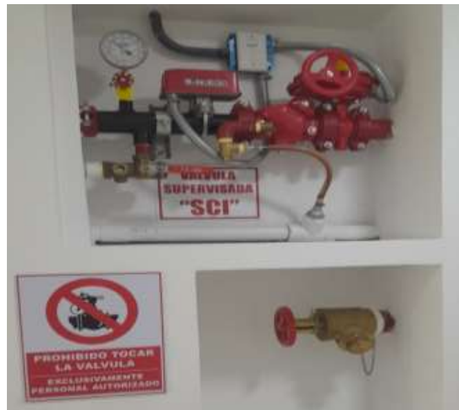
Figura 37 Válvula SCI de alivio de presión.
