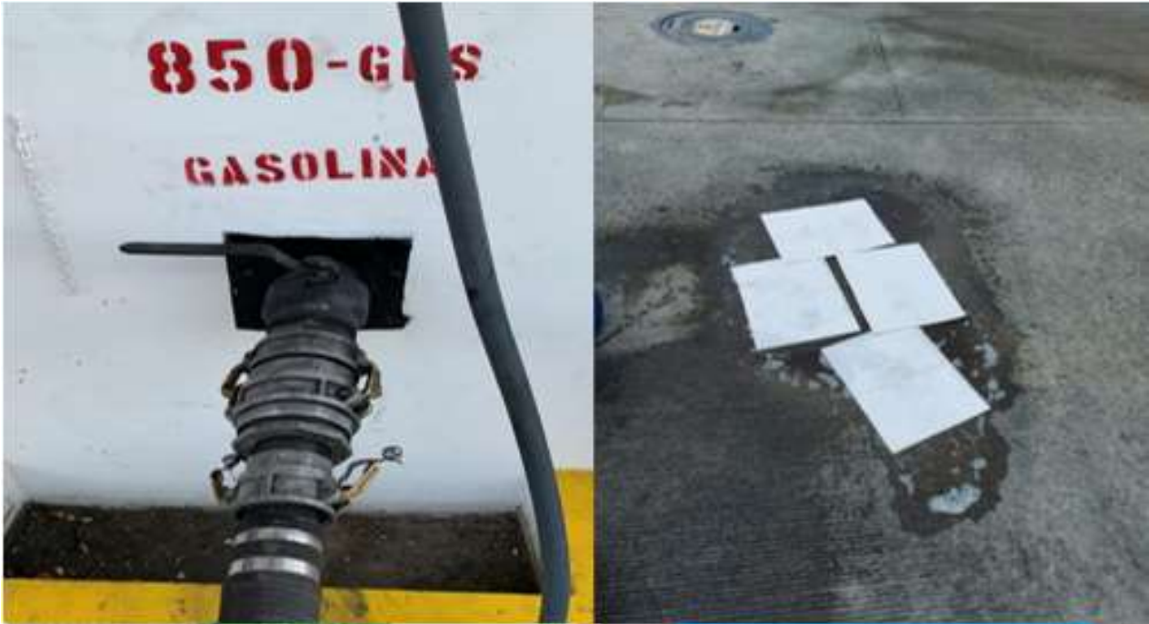
Figura 2: Línea Utilizada para Abastecer Combustible
