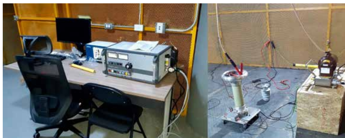
.Laboratorio de Ensayos Eléctricos y Alta Tensión (LEEAT).
