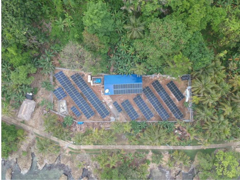
Foto 3. Vista aérea de la planta piloto en La Miel (Crédito: Island Power, S.A.)
