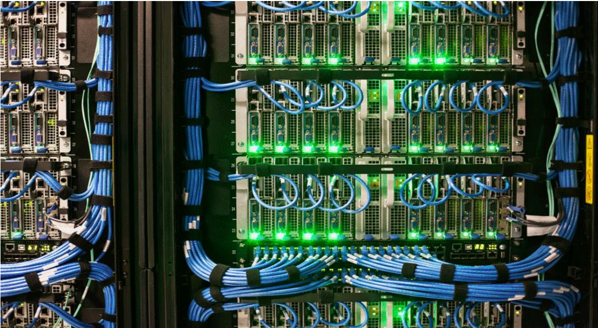
Imagen 6: vista de un centro de datos, que conforman Internet
